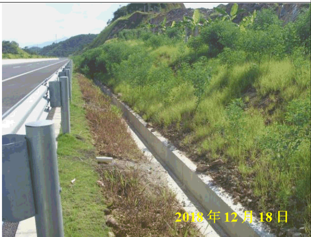
路面布置排水沟及绿化防护现状
